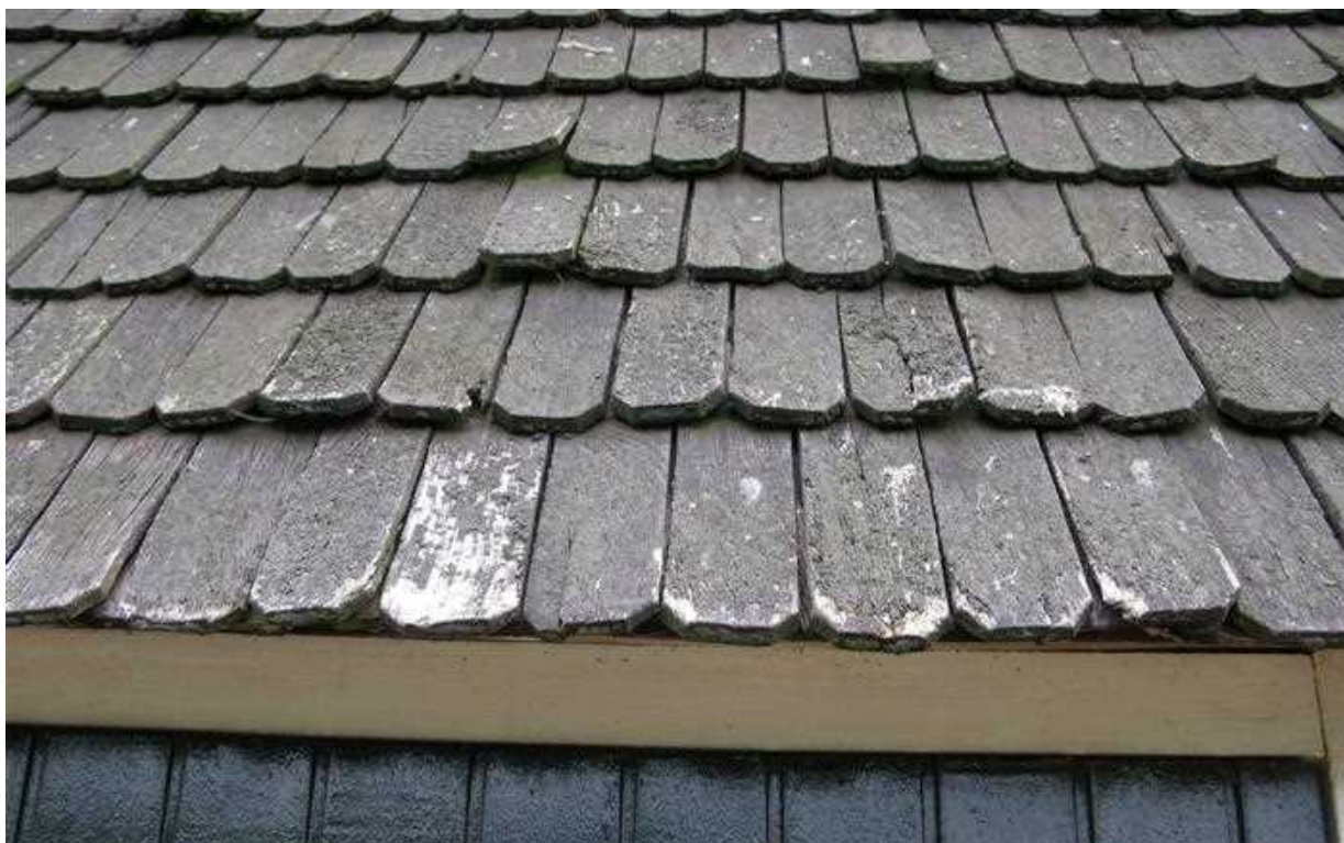
De oude schaliënbedekking, deels gescheurd/gebarsten of stukken afgebroken en kromgetrokken. Vernieuwing is noodzakelijk. Fotocollectie Frits van Lochem
